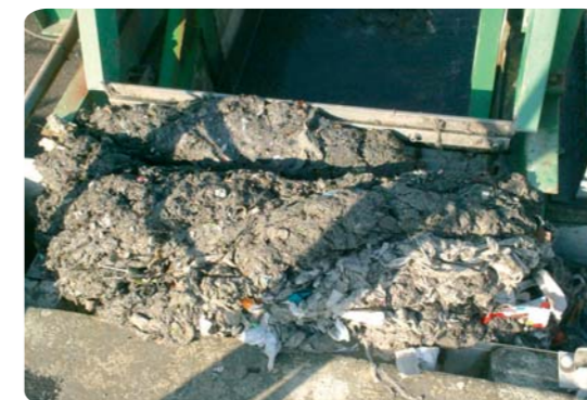
Pollution aux hydrocarbures en entrée de station d'épuration
